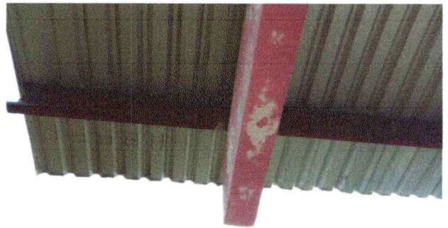
Foto 4: Se observa el mal estado de la infraestructura del techo.
