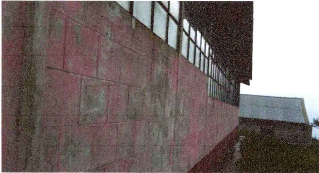
Foto 1: Se observa el deterioro de la pintura de las paredes de la escuela
